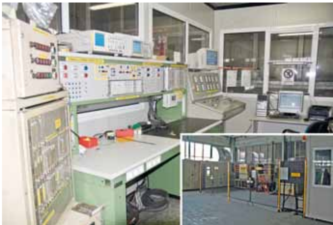
Salle d'essai convertisseurs statiques
